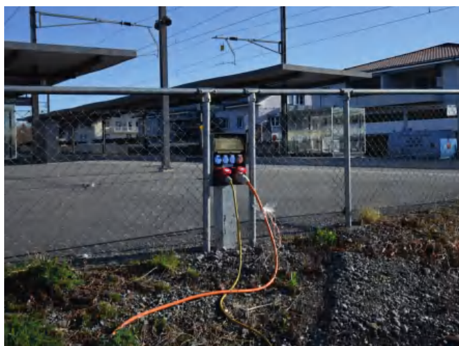
Quadro distribuzione presso la stazione Oberriet
