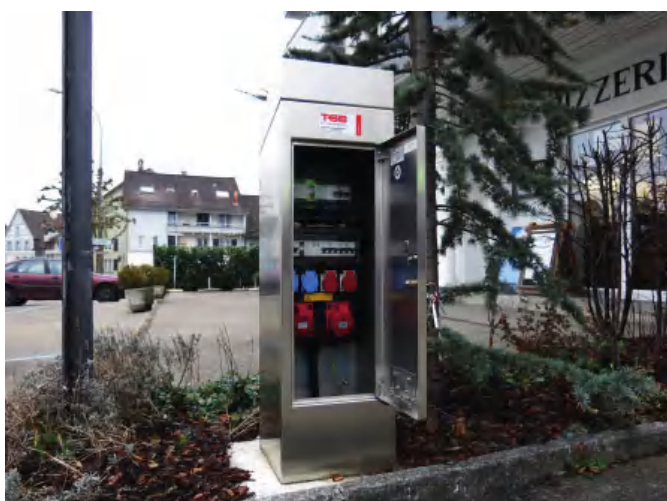
Colonnina d'energia elettrica QUADRO
