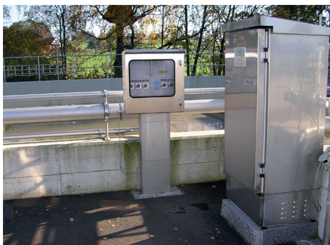
Impianto di depurazione acque
