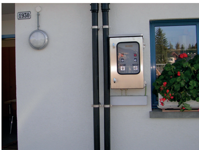
Impianto di depurazione acque
